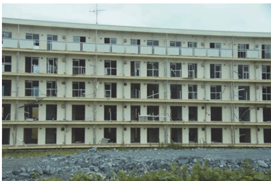
写真7 陸前高田市の市街地に残る津波被害を受けた集合住宅
