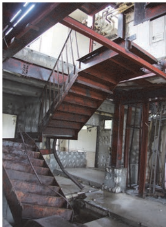
写真3 津波で破壊されたたろう観光ホテルの内部 床や壁が津波で破壊されたことが建物倒壊を助けたとの説明は印象的だった。
