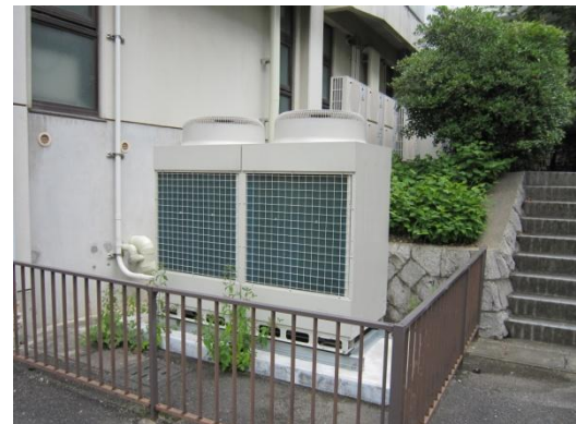
図 6 電算機室用空調室外機
