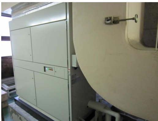
図 5 電算機室用空調機
