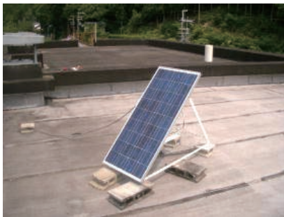
図－11 屋上に設置したソーラーパネル
