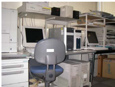
図1 メディアセンター棟の各種サーバ
